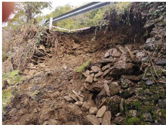
Imatge 03. Estat actual de l'esvoranc
