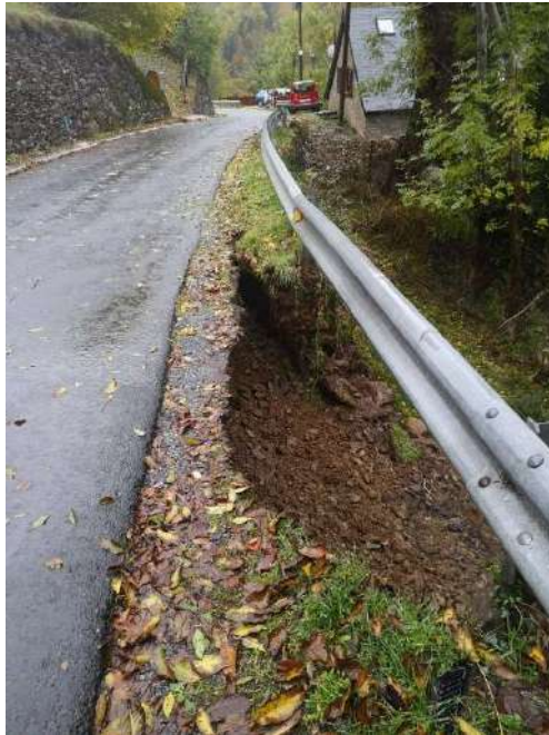
Imatge 02. Estat actual de l'esvoranc.
